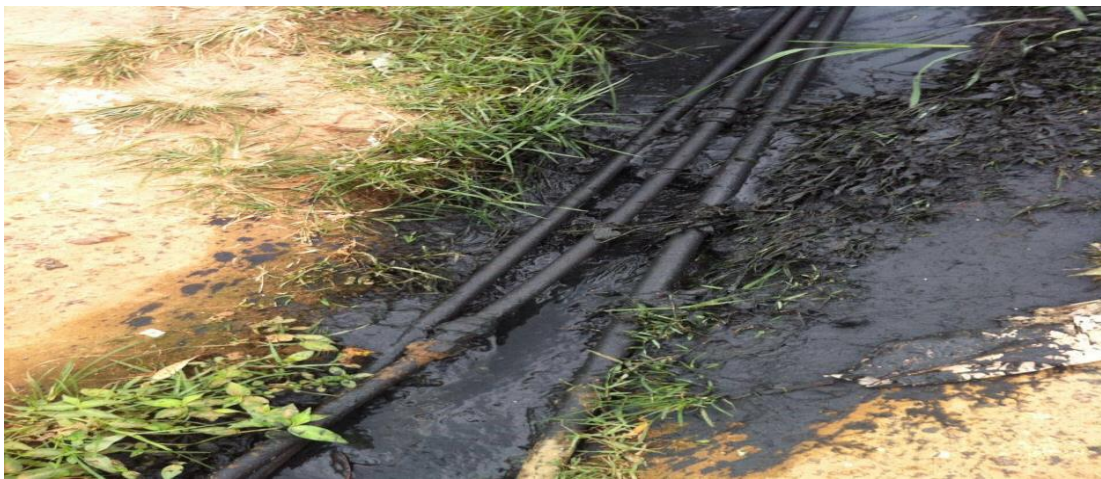
Photo 8 : Vue des déchets liquides dans la nature au carrefour SNI dans la commune d'Owendo (juillet 2016)
